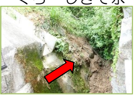
水路の土砂の状況
